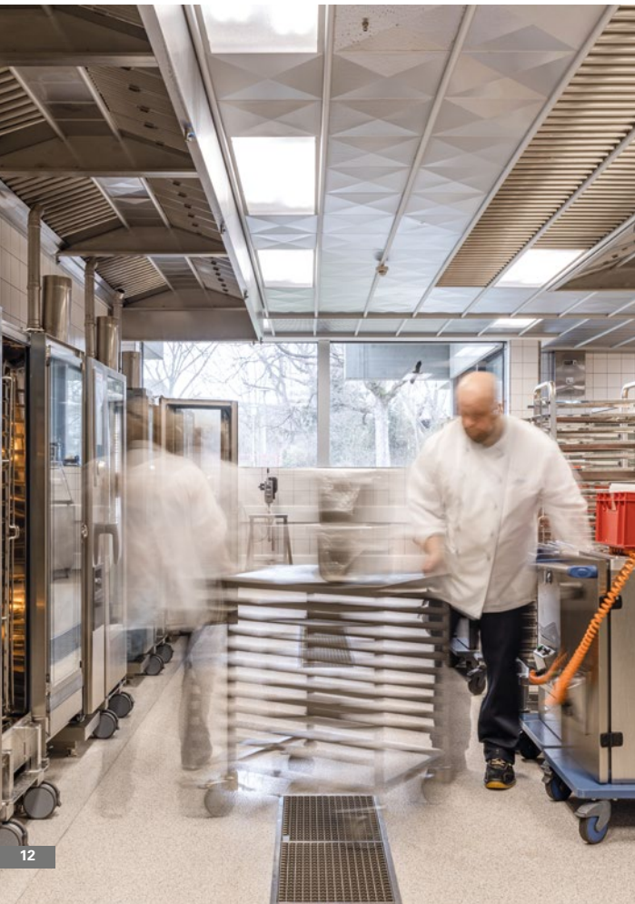
Umbau bei laufendem Betrieb: Die Mannheimer Universitätsmensa war auch während der Sanierung zugänglich.
